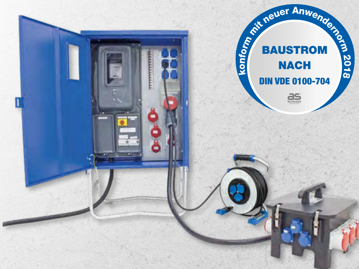
Anschluss-Verteiler-Endverteiler Schränke (A-V-E)
